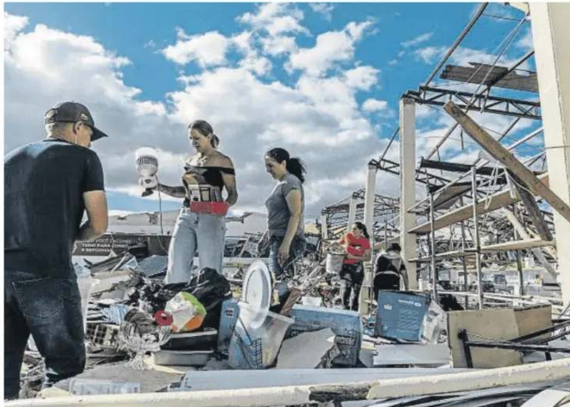
Daños causados por el tornado que azotó el viernes Rio Bonito do Iguaçu (Brasil) y causó 7 muertos
